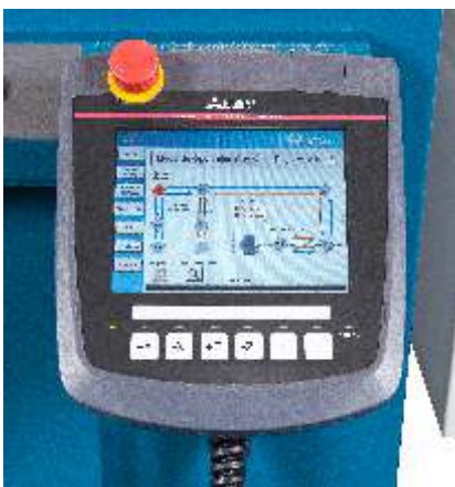
Painel de operação remoto
